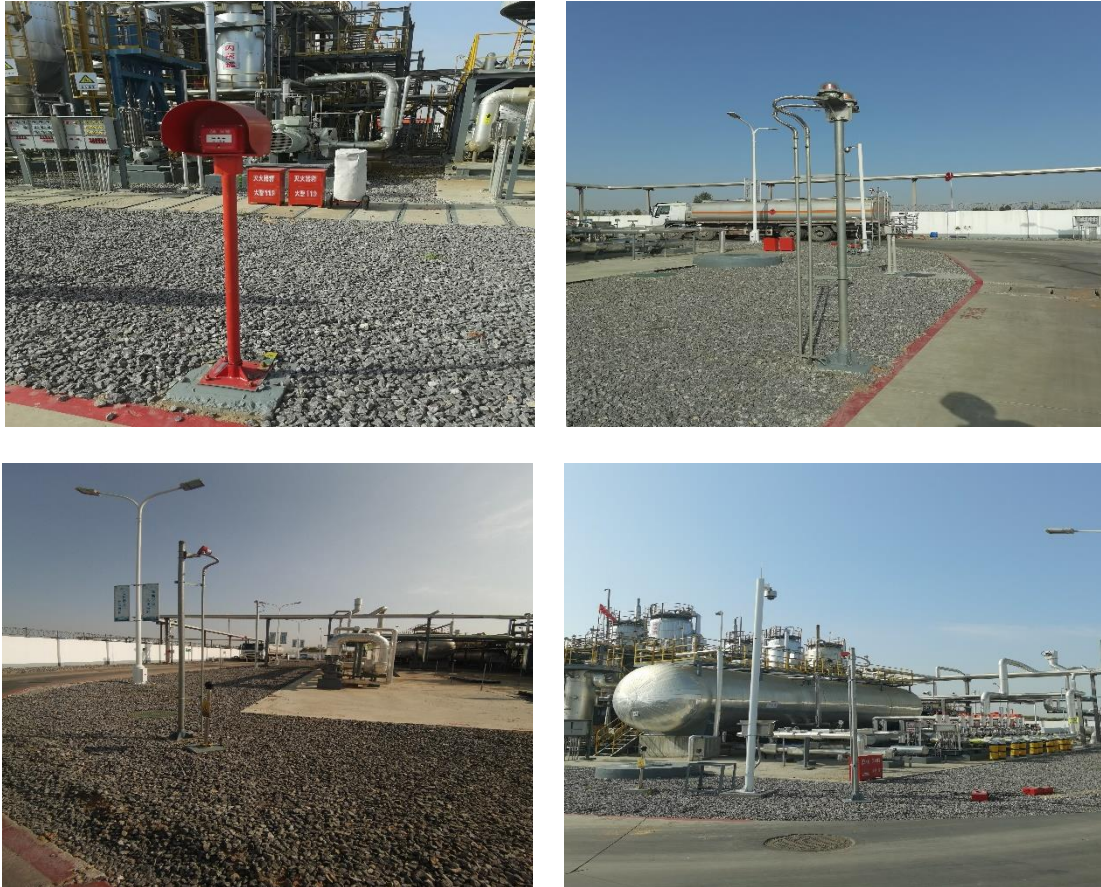
图 4.2-1 项目风险防范措施图片
