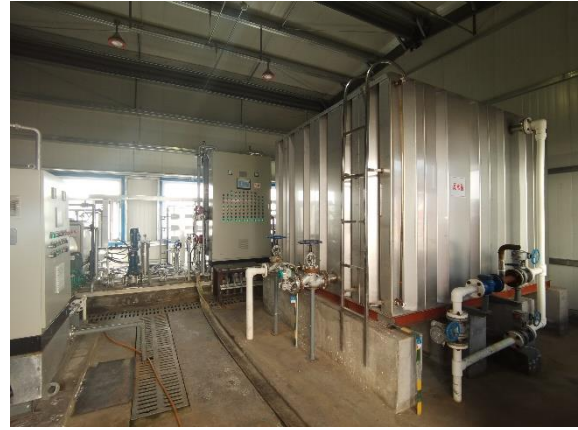
脱盐水处理间
