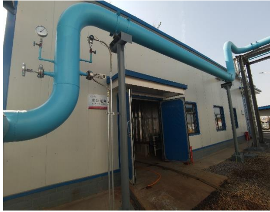
脱盐水处理间
